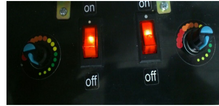
Figura. 18. Unidad de control para variar la velocidad de los motores
