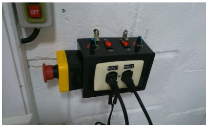
Figura. 17. Implementación del circuito junto con el interruptor de seguridad
