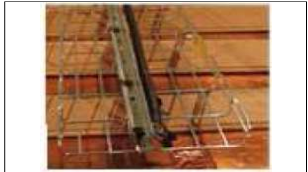
Figura 7: Cables en bandeja tipo malla con separador
