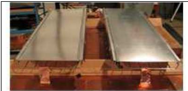
Figura 5: Cables en bandejas tipo malla con tapa paralelas
