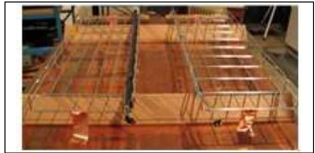
Figura 6: Cables en bandejas tipo malla paralelas
