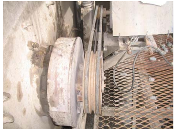
Figura 9. Sistema de transmisión actual en operación
