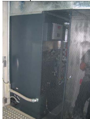
Figura 10. Vista del equipo AA1 y rejilla de succión
