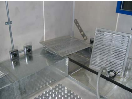
Figura 13. Vista de rejillas y ducto de descarga.
