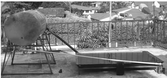
Figura 10. Fotografía panorámica del sistema de calentamiento
