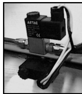
Figura 11. Dos electroválvulas instaladas
